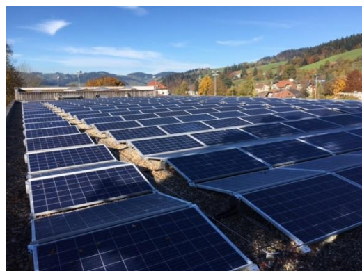
Erweiterung der PV-Anlage auf Turnhalle
