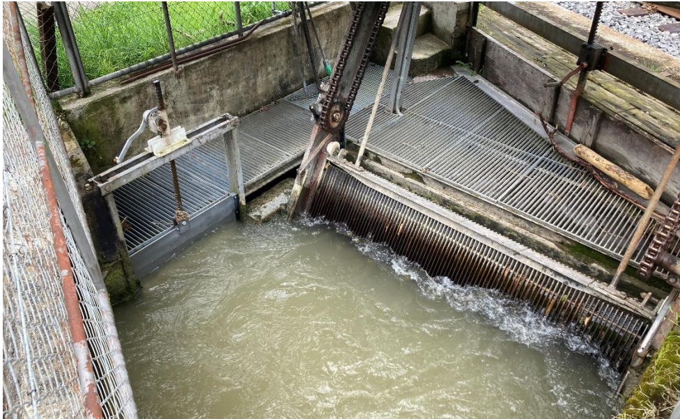
Abbildung 5: Offener Oberwasserkanal und Spülschieber (links) Feinrechen (rechts)
