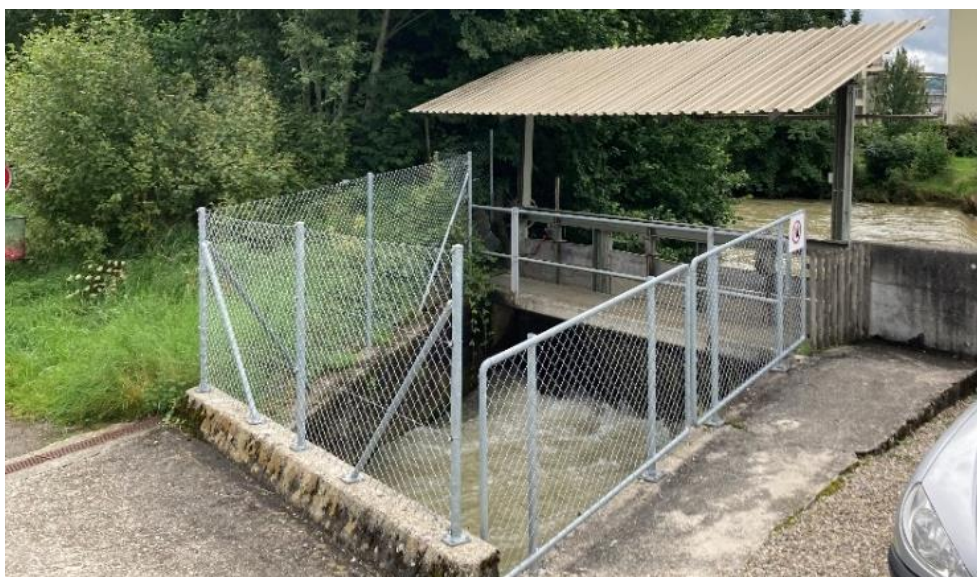
Abbildung 4: Kanaleinlaufschütze vor der Ausleitung in den Gewerbekanal
